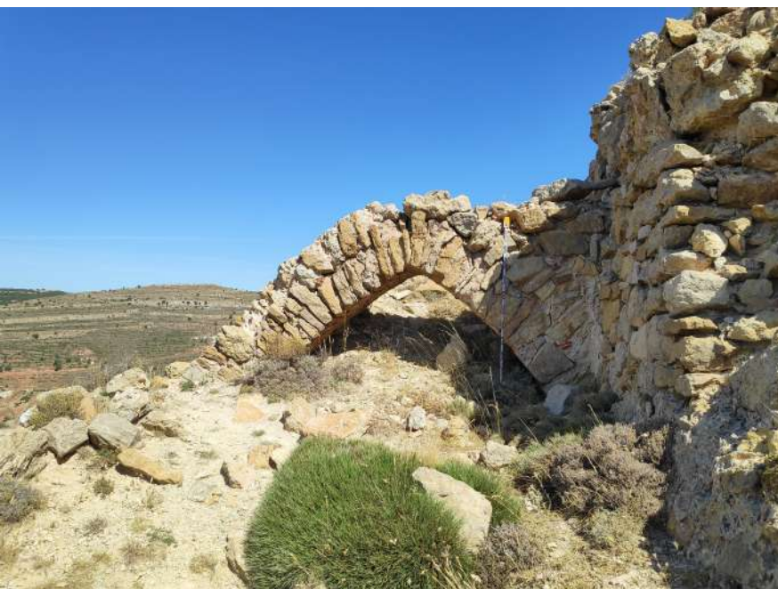
Acceso principal de la fortaleza, parcialmente cubierto por el derrumbe de los muros perimetrales. Imagen de Rosario Serrano.
